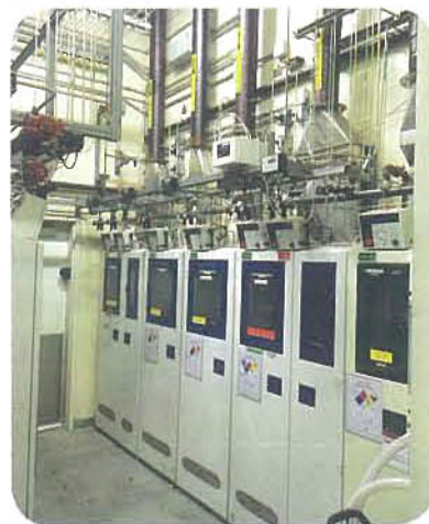
图3: 凌力尔特晶圆制造厂里的有毒气体柜处于严密监视之下,以确保正常运行时间
